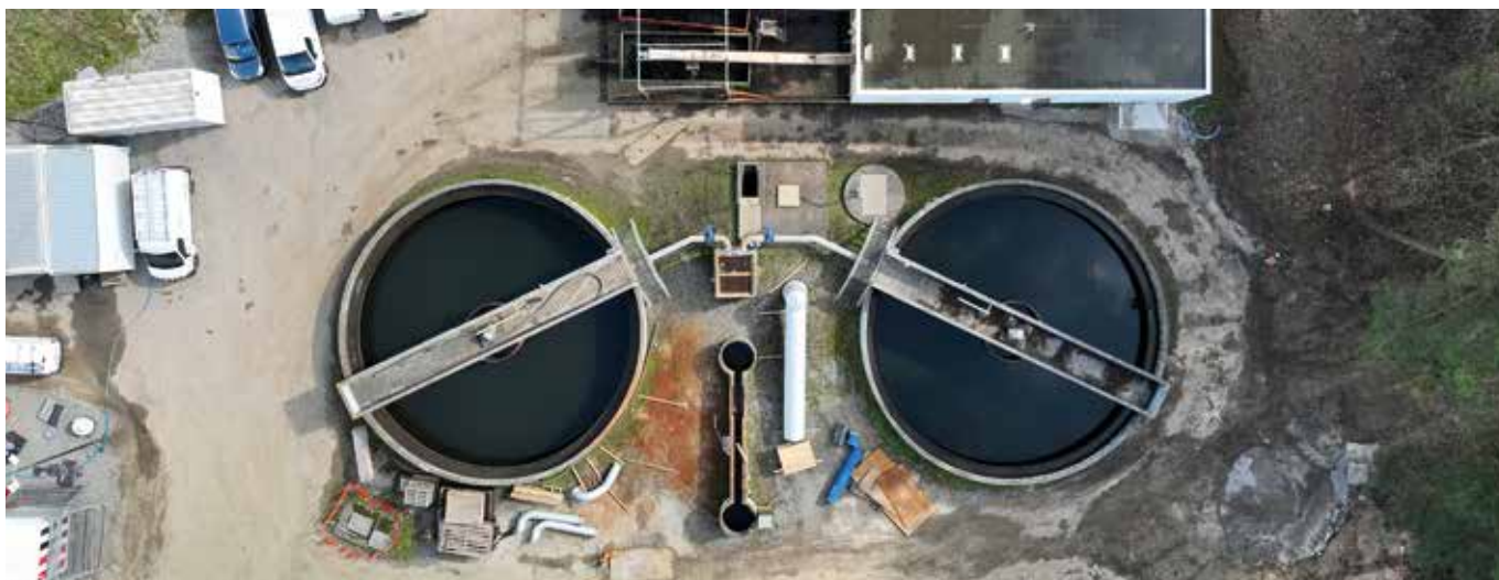
Saturateurs à chaux, usine d'eau potable de Vilaine Atlantique
